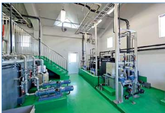
浸出水処理設備
