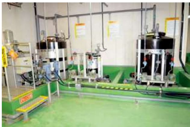
薬品タンクヤード
